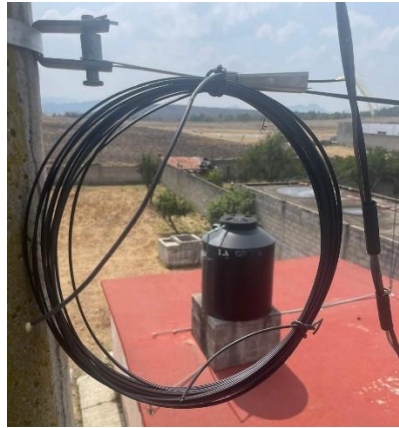
Figura 6.20 Reserva para mantenimiento e instalación de cajas NAP (elaboración propia).
