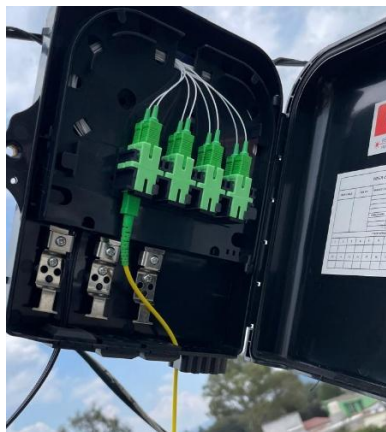
Figura 6.38 Conexión al puerto de la caja NAP (elaboración propia).
