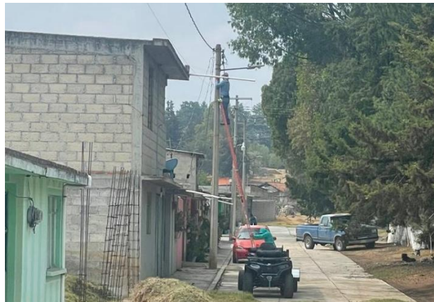
Figura 6.21 Instalación final de la red troncal (elaboración propia).
