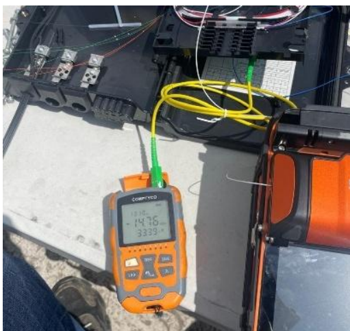
Figura 6.28 Potencia de la tercera caja NAP (elaboración propia).
